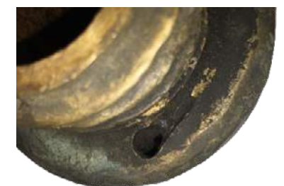
Observez le percement transversal du passage du câble
